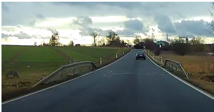
Obrázek 5: Vlevo nahoře koroze svodidla vlevo (km 77,14 – 77,21), vpravo nahoře nedostatečná krajnice za svodidlem vpravo (km 77,14 – 77,21), dole svodidlo v km 78,32.
