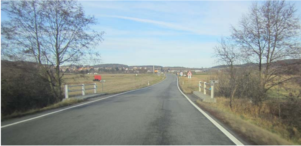
Obrázek 8: Pohled proti směru staničení – nevhodný záchytný systém na mostě ev. č. 144-015.
