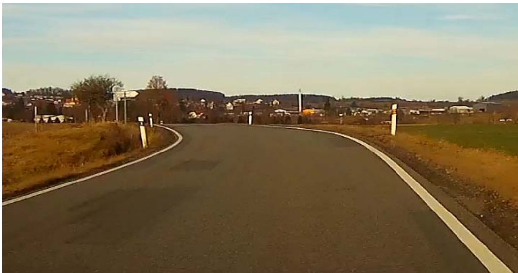
Obrázek 3: Pohled proti směru staničení – vyjetá krajnice na obou stranách oblouku v km 14,49.
