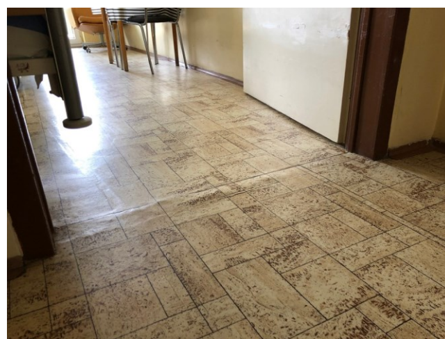
Obr. 8 - pavilon C (LDN) – nerovnosti podlahy
