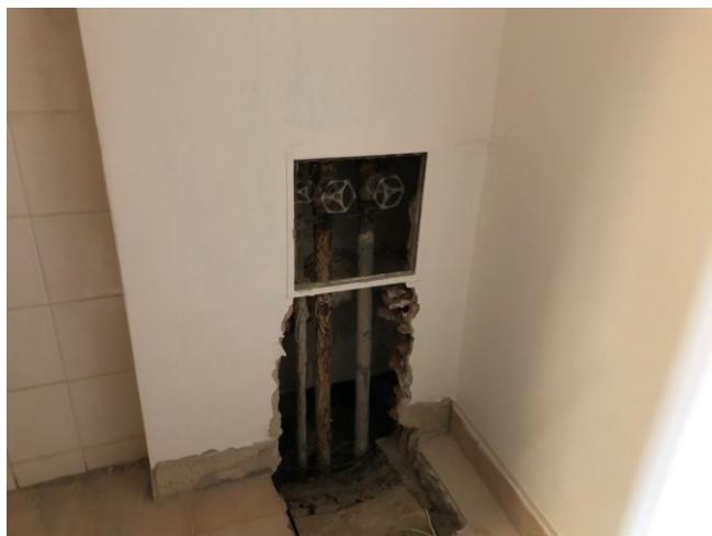
Obr. 7 - pavilon C (LDN) – prasklé vodovodní přípojky
