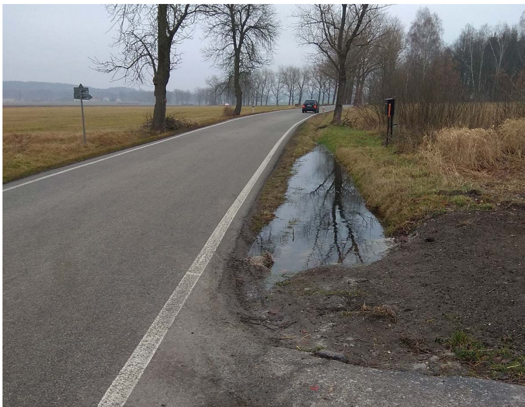
Obrázek 3: Pohled po směru staničení na vodu stojící v pravém příkopu.
