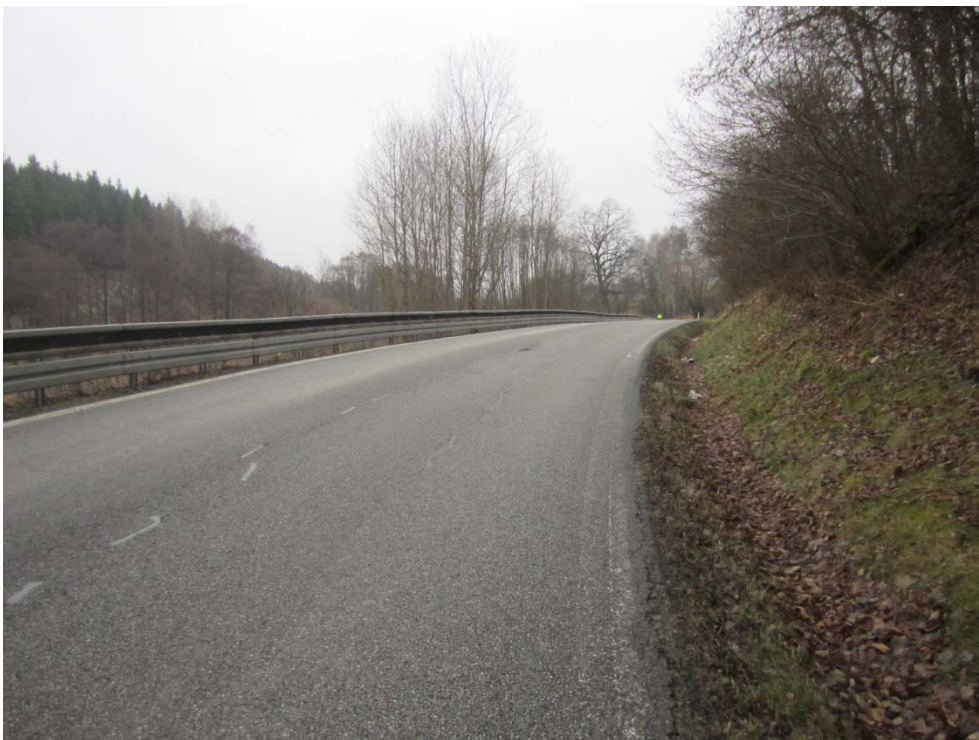
Obrázek 5: Směrový oblouk s nedostatečnými rozhledovými poměry.
