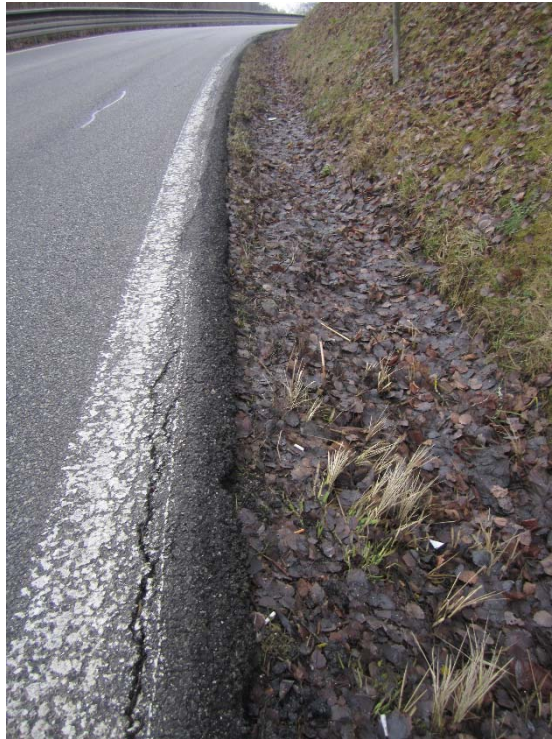
Obrázek 6: Zanesené odvodňovací zařízení.
