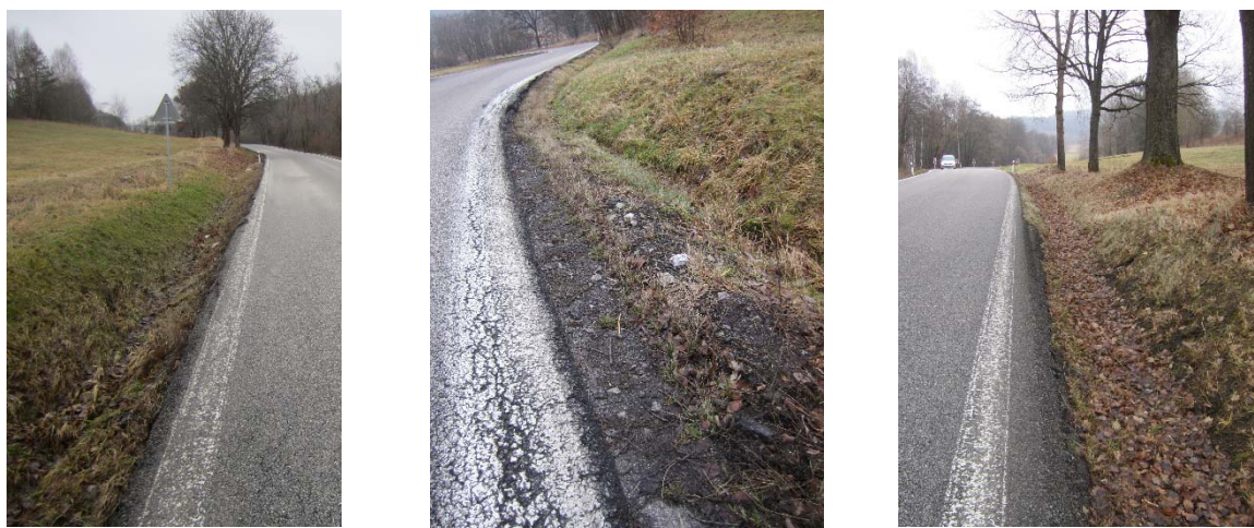
Obrázek 3: Příklady chybějících nezpevněných krajnic.
