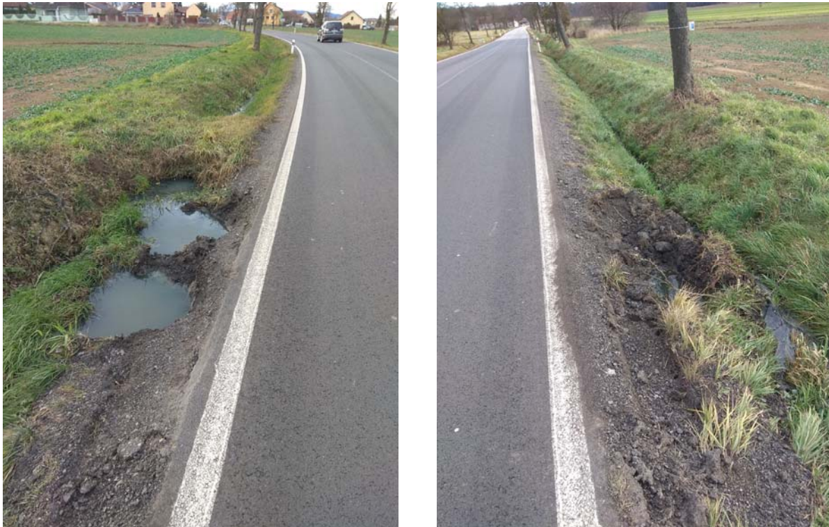
Obrázek 6: Poškozené těleso silnice – vlevo pohled ve směru na Branišov, vpravo pohled ve směru na Č. Budějovice.
