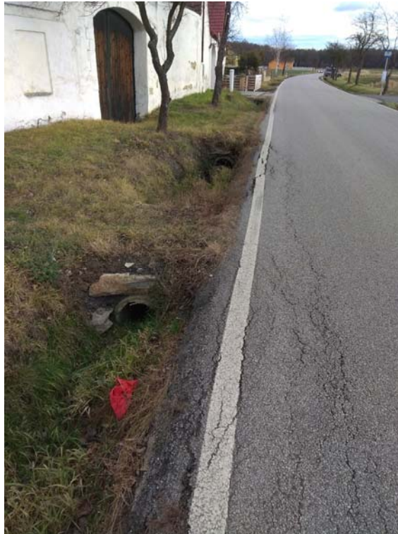
Obrázek 4: Poškozený okraj vozovky – pohled ve směru na Č. Budějovice.
