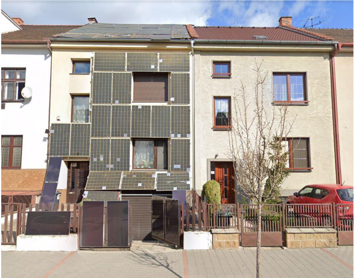
Brno Židenice, negativní instalace FVS na plášť domu, bez vztahu k charakteru objektu či místa, narušuje celkovou kompozici objektu a významně se uplatňuje ve vnímání širšího území, viditelnost FVS v blízkých i dálkových pohledech
