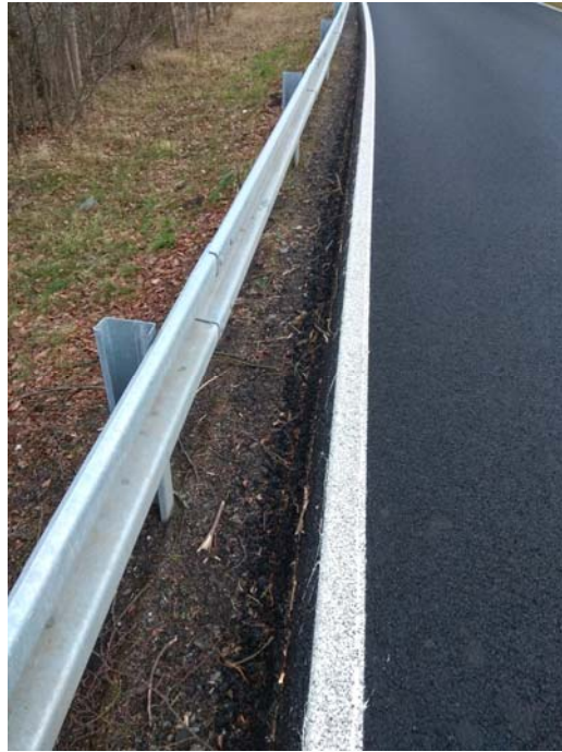
Obrázek 5: Nedostatečná krajnice v místě svodidel.
