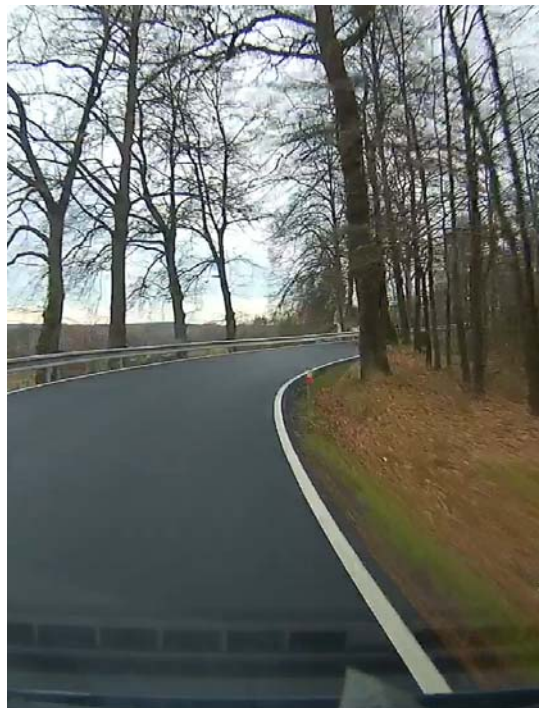
Obrázek 6: Nedostatečný rozhled pro zastavení ve směrovém oblouku – pohled ve směru na Dvorce.
