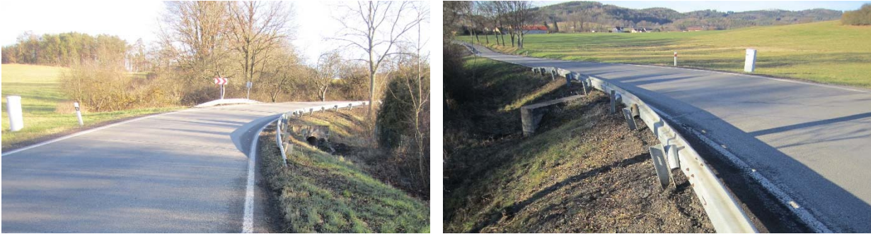
Obrázek 9: Vlevo pohled na svodidla proti směru staničení, vpravo pohled na levé svodidlo po směru staničení – deformace sloupků a distančních dílů.
