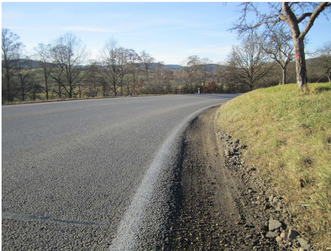
Obrázek 6: Absence odvodňovacího zařízení vpravo (pohled po směru staničení, oblouk km 25,36).
