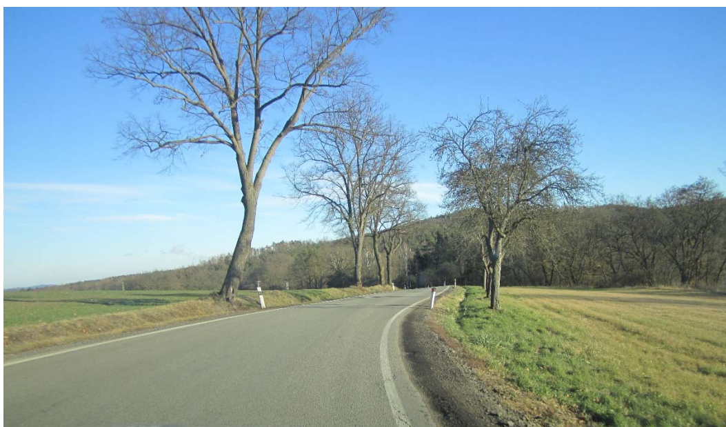
Obrázek 3: Pohled proti směru staničení – mezipřímá v km 24,94 - 25,04 – rozbité krajnice.
