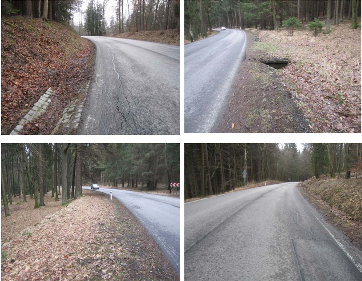
Obrázek 12: Nefunkční odvodnění komunikace - příkop.
