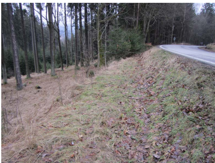
Obrázek 7: Absence zádržného systému.
