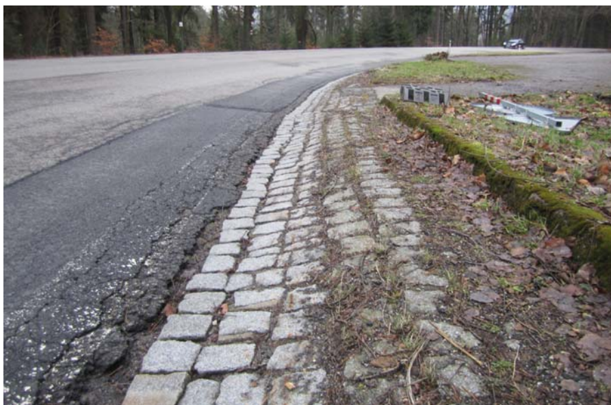
Obrázek 11: Pohled na poškozený okraj komunikace.
