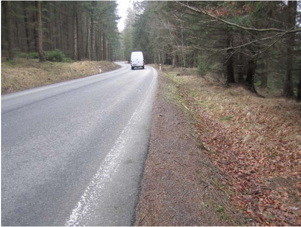
Obrázek 3: Ukázka nezpevněných krajnic na úseku.
