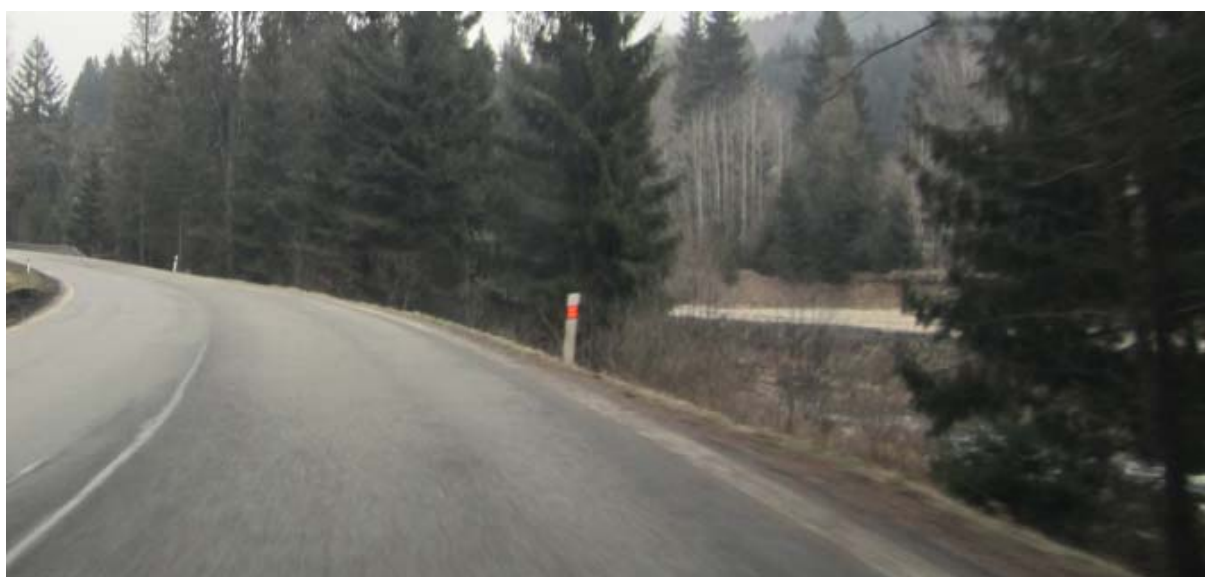
Obrázek 11: Absence zádržného systému.
