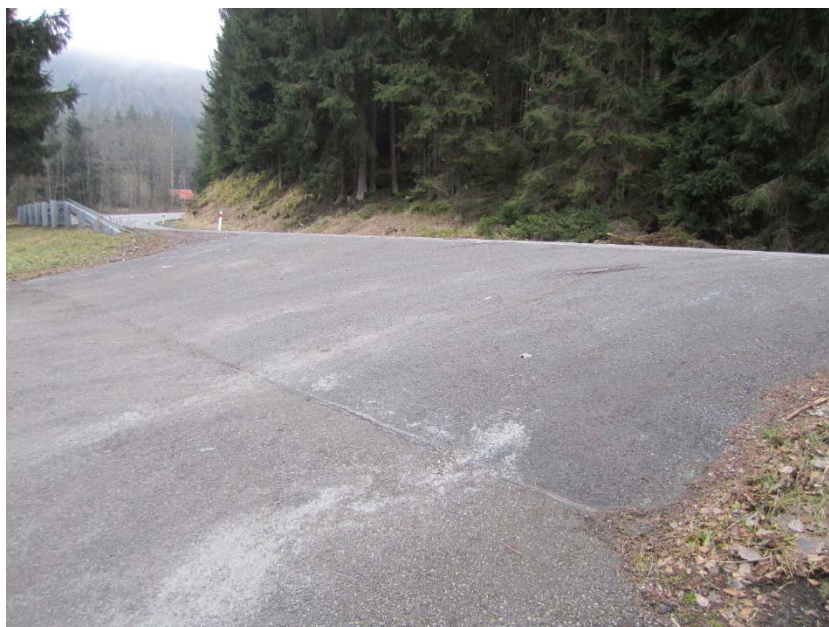
Obrázek 9: Nájezd na silnici II. třídy od provozovny i s poruchami povrchu.
