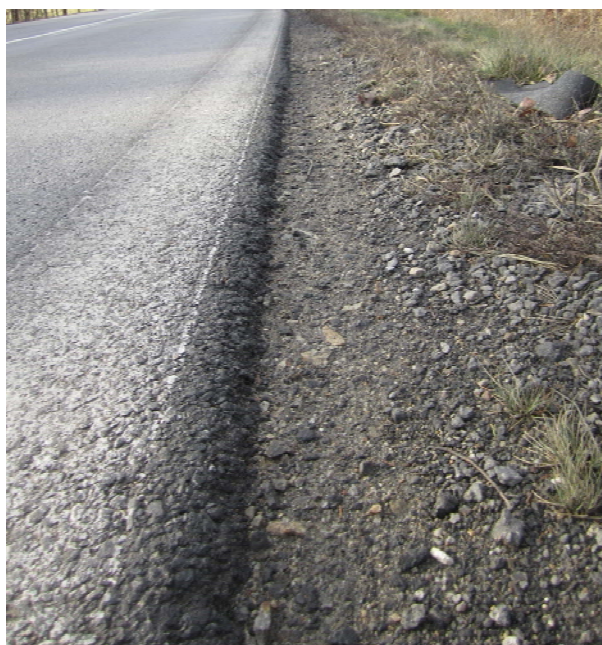
Obrázek 3: Pohled proti směru staničení – vyjetá krajnice na vnější straně oblouku (levá po směru staničení).
