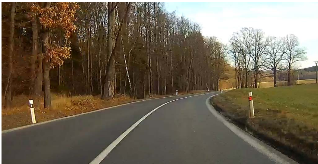
Obrázek 8: Pohled do oblouku po směru staničení (vpravo absence krajnice a odvodnění).
