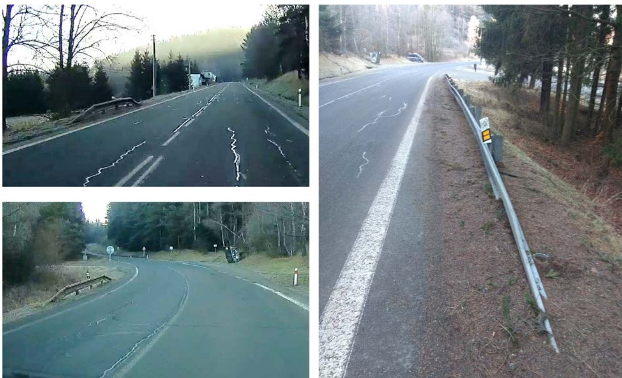
Obrázek 7: Pohled po směru staničení (vlevo km 46,15, vlevo dole km 46,50), vpravo pohled proti staničení na svodidlo v km 46,57 – 46,60.
