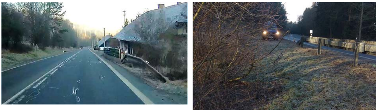
Obrázek 8: Obrázek vlevo – Km 46,38 - ohled proti směru staničení na svodidlo a plot. Obrázek vpravo – km 47,12 - průhled z násypu na silnici III/145 (proti směru staničení) – riziko vyjetí vozidla mimo vozovku přímo dolů ze svahu.
