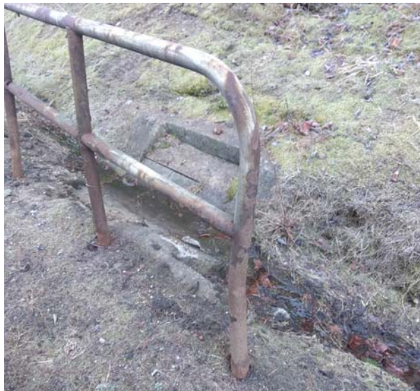
Obrázek 13: Pohled na zakrytou HV se zábradlím v km 47,23.
