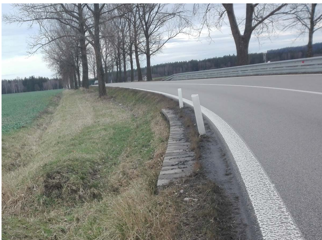
Obrázek 3: Pohled po směru staničení – rozbité směrové sloupky v oblouku v km 2,03.
