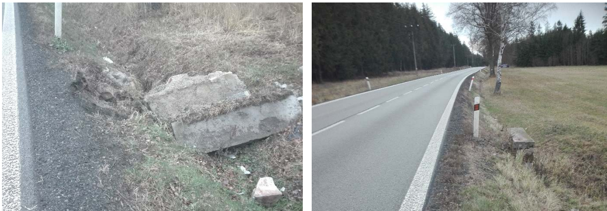
Obrázek 7: Pohled na čela propustků (vlevo km 1,52, vpravo km 1,75) proti směru staničení. Dole kolmá čela propustku v km 3,17 (vlevo rozbité vtokové čelo).
