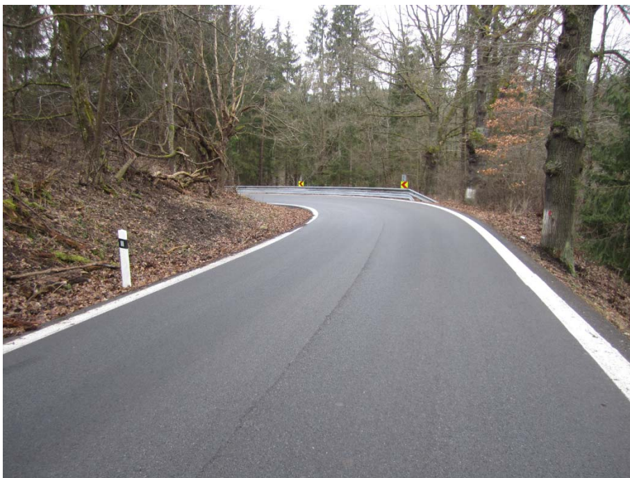
Obrázek 9: Pohled na nedostatečnou délku svodidla
