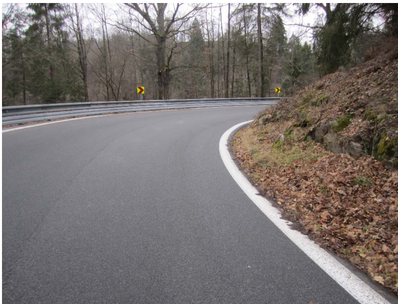
Obrázek 10: Nedostatečné rozhledové poměry ve směrovém oblouku
