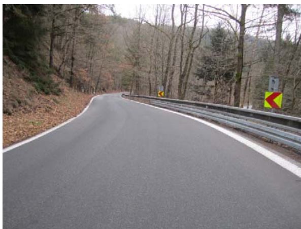
Obrázek 7: Příklad nefunkčního či chybějícího odvodnění komunikace
