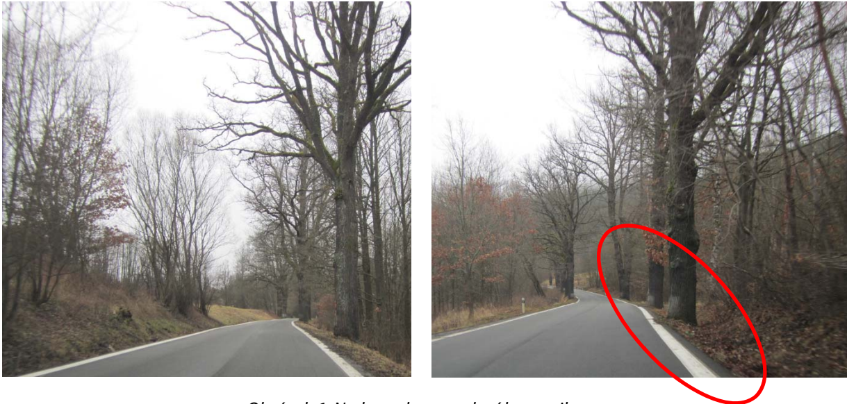
Obrázek 6: Nedostatky ve vedení komunikace.
