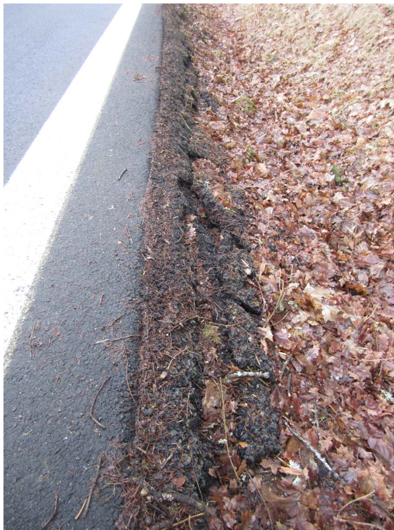
Obrázek 13: Poškození kraje vozovky
