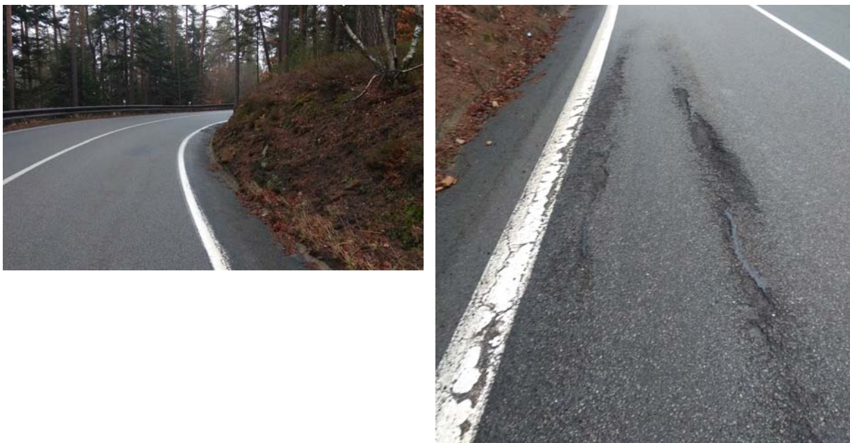
Obrázek 6: Vlevo pohled do oblouku (délka rozhledu okolo 36 m) proti směru staničení, vpravo poškození vozovky v levém pruhu (pohled po směru staničení)
