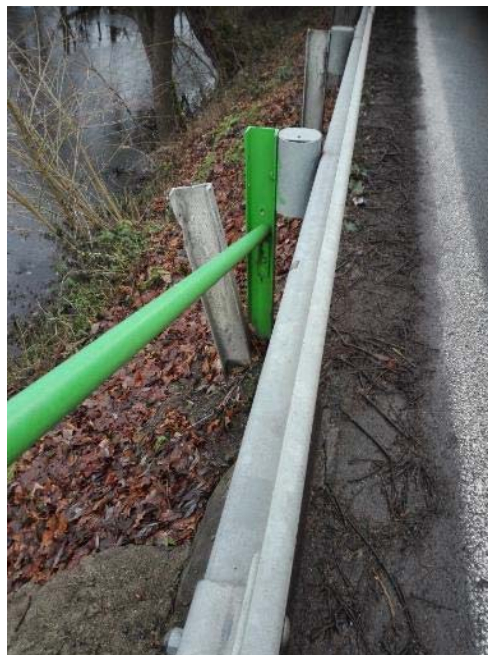
Obrázek 18: Pohled na svodidlo vlevo za mostem – nedostatečná šířka krajnice.
