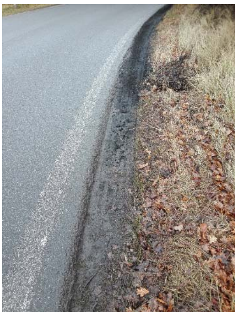
Obrázek 5: Chybějící nebo nevyhovující krajnice.
