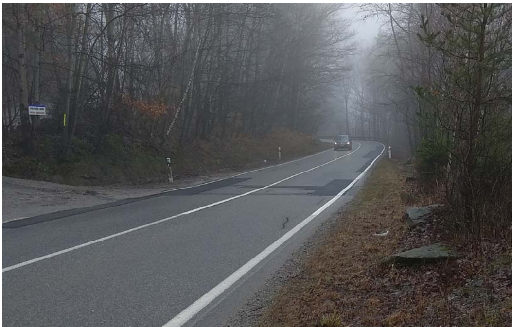
Obrázek 3: Pohled proti směru staničení do oblouku v km 2,09, kde dochází k DN.
