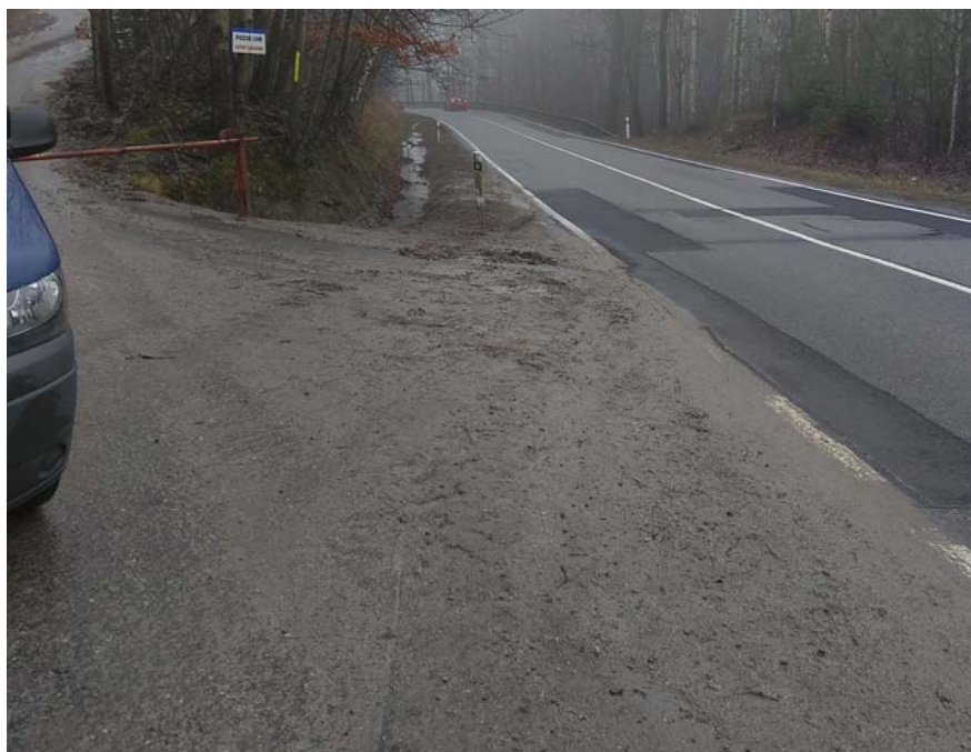
Obrázek 16: Pohled proti směru staničení – znečištěný sjezd
