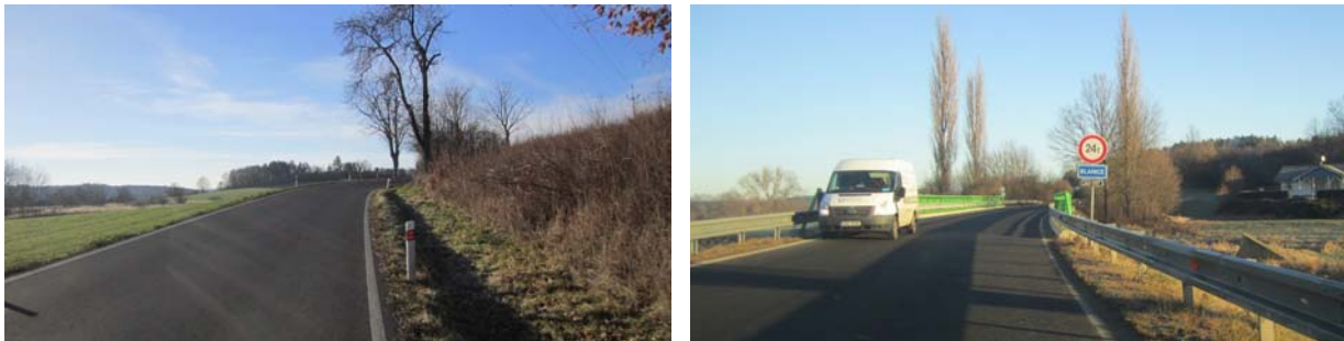
Obrázek 5: Vlevo nedostatečný rozhled v oblouku v km 2,82 (pohled ve směru staničení), vpravo nedostatečný rozhled pro zastavení ve vnitřním oblouku na mostě ev. č. 140-007 (pohled ve směru jízdy proti směru staničení).
