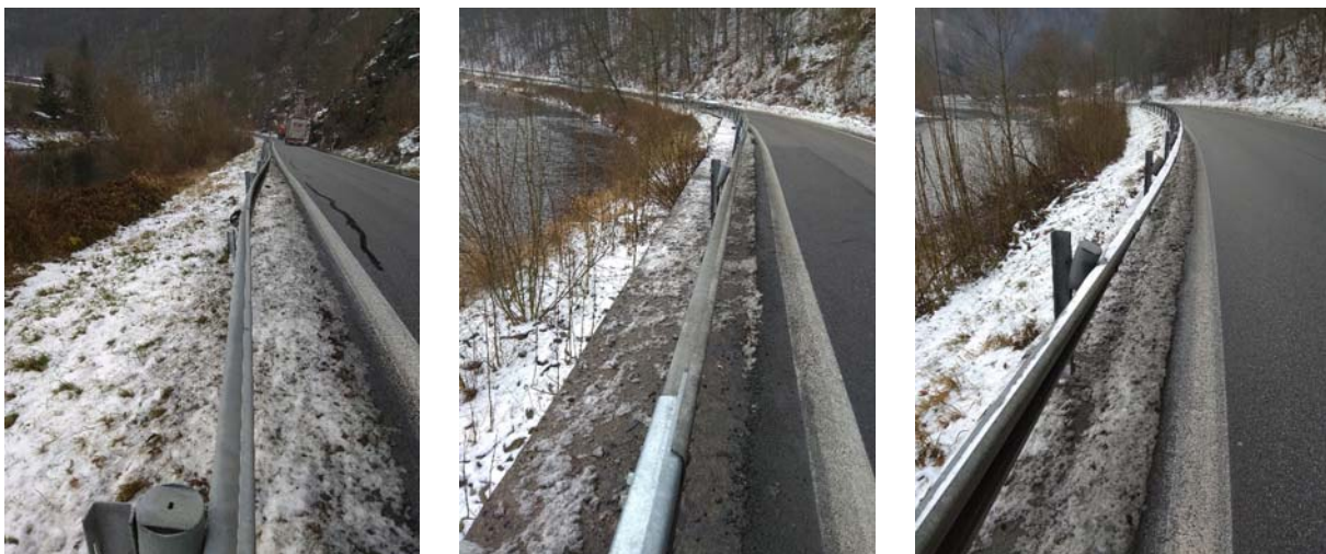
Obrázek 5: Ukázka poškozených svodidel.
