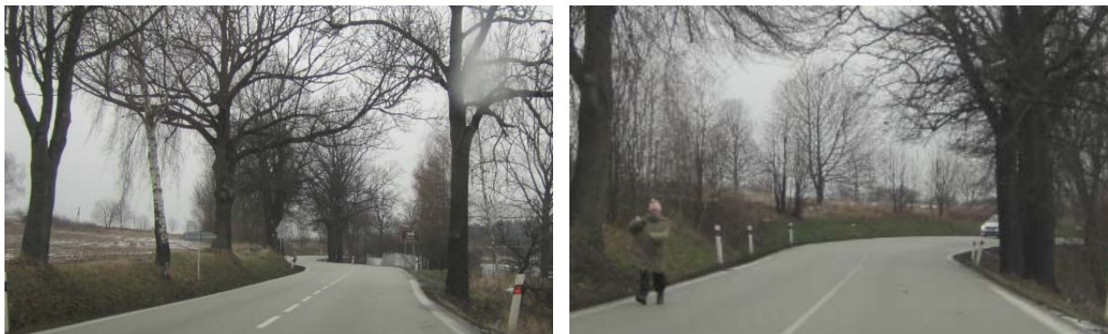
Obrázek 4: Pohled po směru staničení – stromy v malé vzdálenosti od hrany zpevnění.
