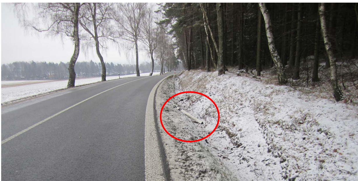
Obrázek 5: Nefunkční směrové sloupky.
